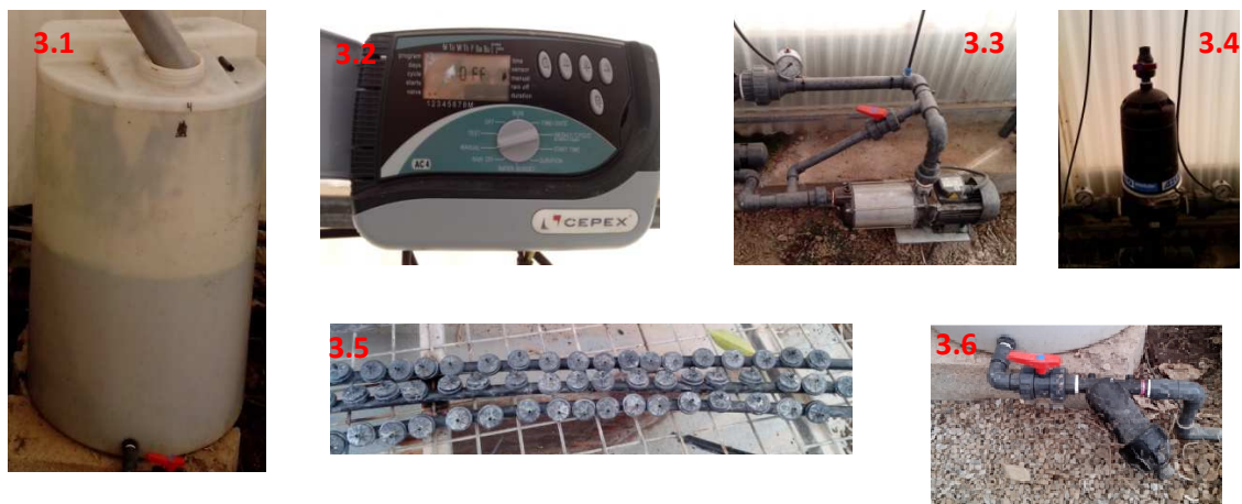
Fotografía 3.- Depósito de 200L de capacidad (1.1); programador de riego (1.2); bomba hidráulica con manómetro y baipás para regular la presión (1.3); filtro de anillas con manómetros a la entrada y salida (1.4); filtro de malla a la salida del depósito (1.5).
